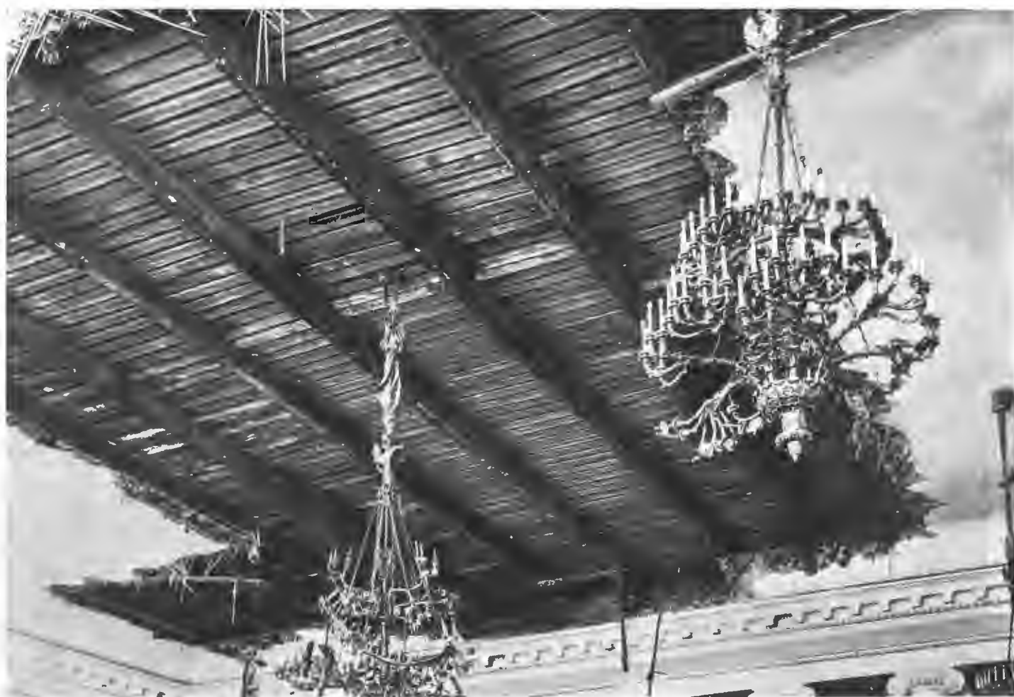
Часть обвалившегося потолка съ поврежденными люстрами.
